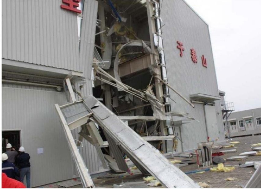
شکست تردد در تست نیوماتیک یک مخزن ذخیره سوخت
